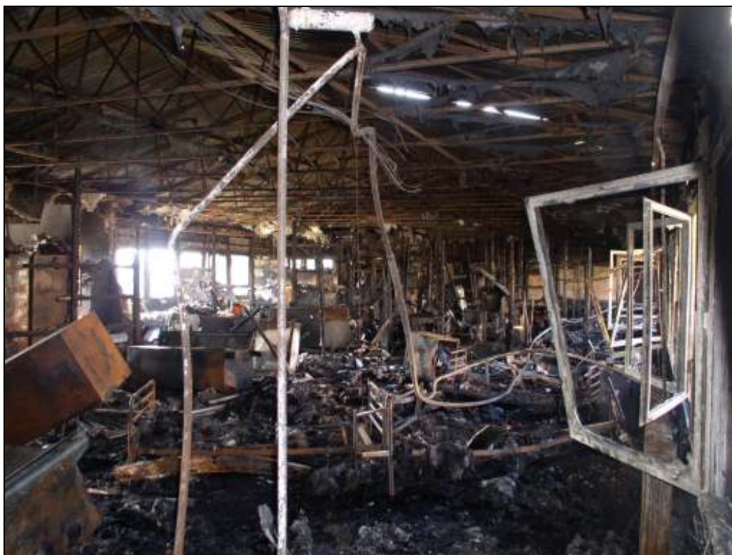
Abb. 1: Blick in das abgebrannte Gebäude
